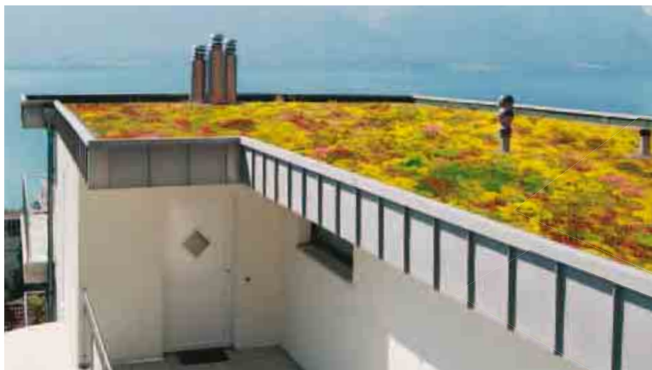
Végétalisation extensive de toiture
